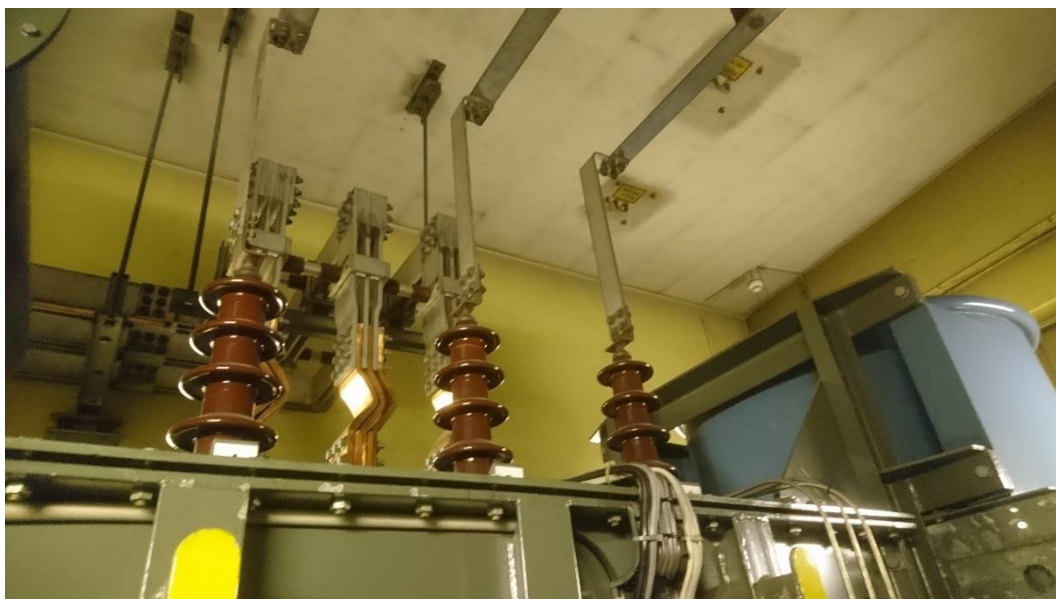
Figur 16. Interiör från transformatorhall, högspänningsskenor.
