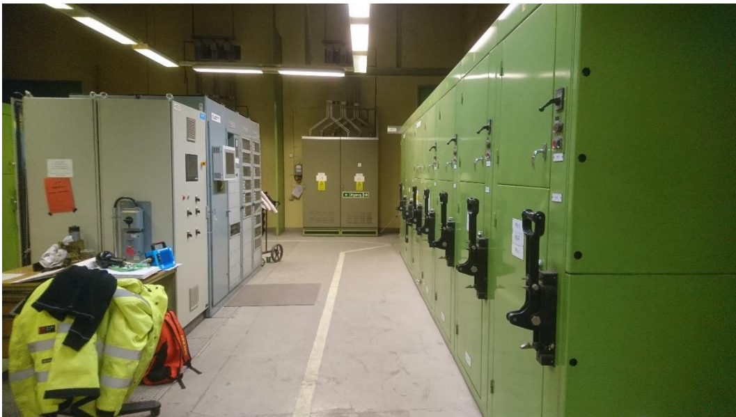
Figur 15. Interiör från likriktarhall, likspänningsställverk syns till höger i bild.
