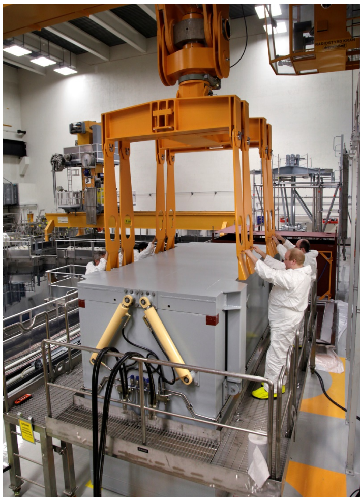
Figur 2-2. Transportlådan med BFA-tank över lyftschaktet till reaktor 2 på Forsmarks kärnkraftverk.
