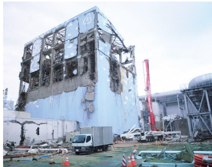
Foto på reaktorbyggnad 4 vid Fukushima 1 Nuclear Power Plant. Från https://mainichi.jp/english/articles/20160312/p2a/00m/0na/015000c
