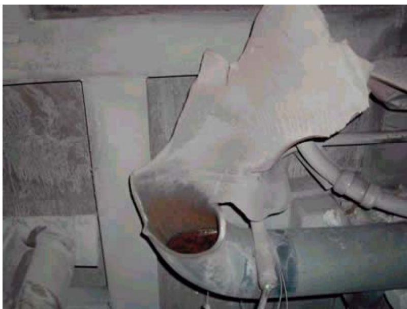
Figur 1: Rörböj DN 150 med godstjocklek 11 mm skadad vid en knallgasincident i den japanska kokarreaktorn Hamaoka-1 (Chubu Electric Power Company, med tillstånd).
